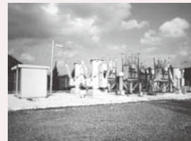
配電自動化システム
