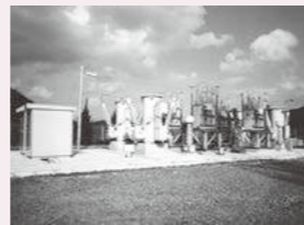
配電自動化システム
