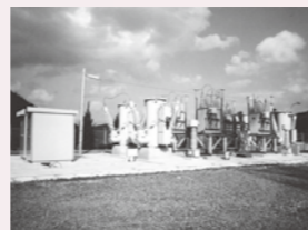
配電自動化システム
