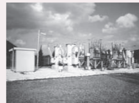
配電自動化システム
